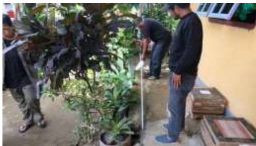
Tim pendataan melaksanakan kegiatan pengukuran sisa pondasi rumah injil ibadah pertama Desa Buli asal.
